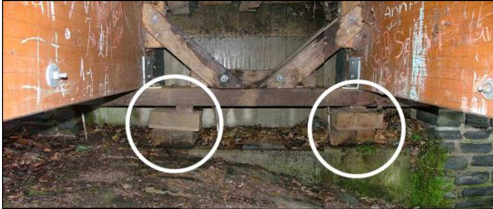
Röderbachbrücke bei Dhronecken: Auflagerung der Brücke nicht fachgerecht
