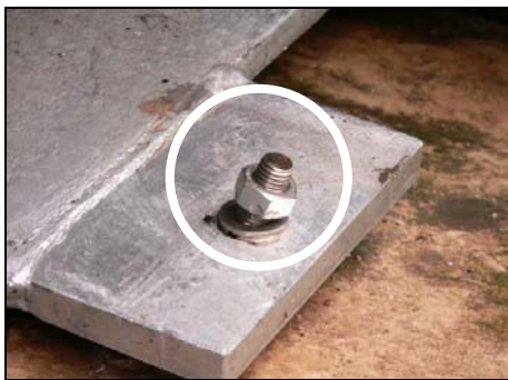
Landesstraße 538 (Westheim - Bellheim) lose Verschraubung
