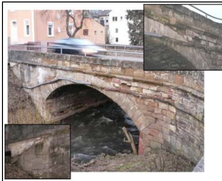
L 347 - Reichenbachbrücke in Heimbach Zustandsnote 3,5
